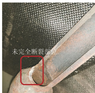
图 3 爆裂管道端部断裂宏观形貌
